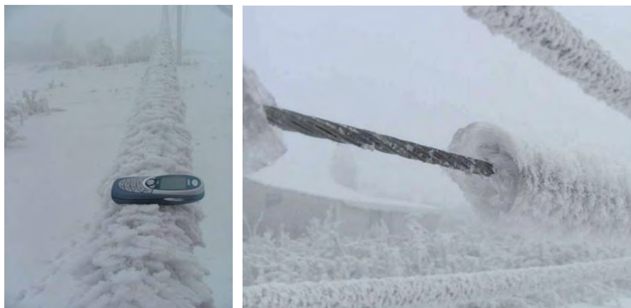
Rys. 11. Zerwane przewody linii 15 kV z widoczną warstwą osadu lodowego (fot. Marek Rogóż)
