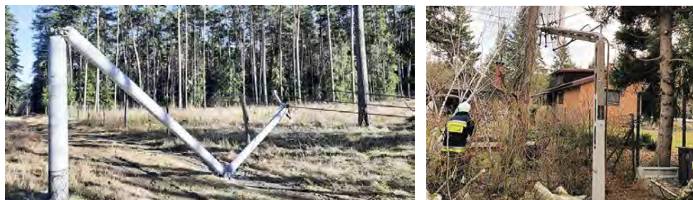
Rys. 7. Skutki wichury i ulewnego deszczu – połamane słupy linii SN [Energia El. 2022]
