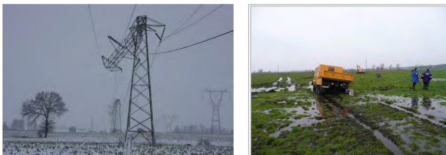
Rys. 10. Złamany słup 110 kV oraz błoto utrudniające wykonanie napraw (fot.R.Rataj 8.04.)
