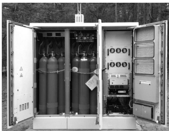
Rys. 4. Zdjęcie instalacji zasilania awaryjnego z ogniwami PEMFC i zbiornikami wodoru
