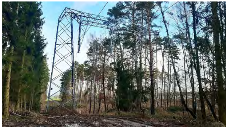
Rys. 8. Uszkodzony słup linii 110 kV na terenie działania firmy Enea Operator w północno-zachodniej Polsce (fot. media.enea.pl)
